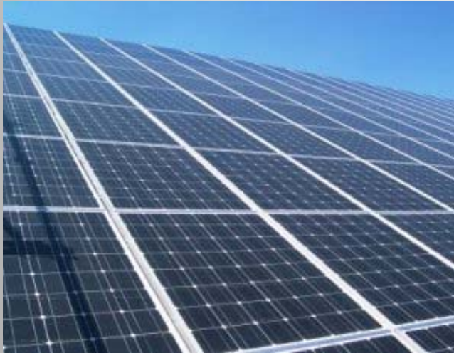
Impianti fotovoltaici realizzati da Fintel nella Provincia di Macerata
