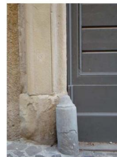
fig. 2 stato di conservazione spalla portone ingresso
