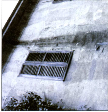
Immagine 8 – Villa Litta-Modignani, Ossona (MI). Particolare del prospetto ovest. Esempio di interazione fra gli elementi. Il cattivo funzionamento dell'impianto di smaltimento delle acque meteoriche, dovuto alla presenza di un foro nel canale di gronda, consente la percolazione dell'acqua piovana lungo la parete causando evidenti fenomeni di degrado sia sull'intonaco esterno sia sulla muratura portante.
