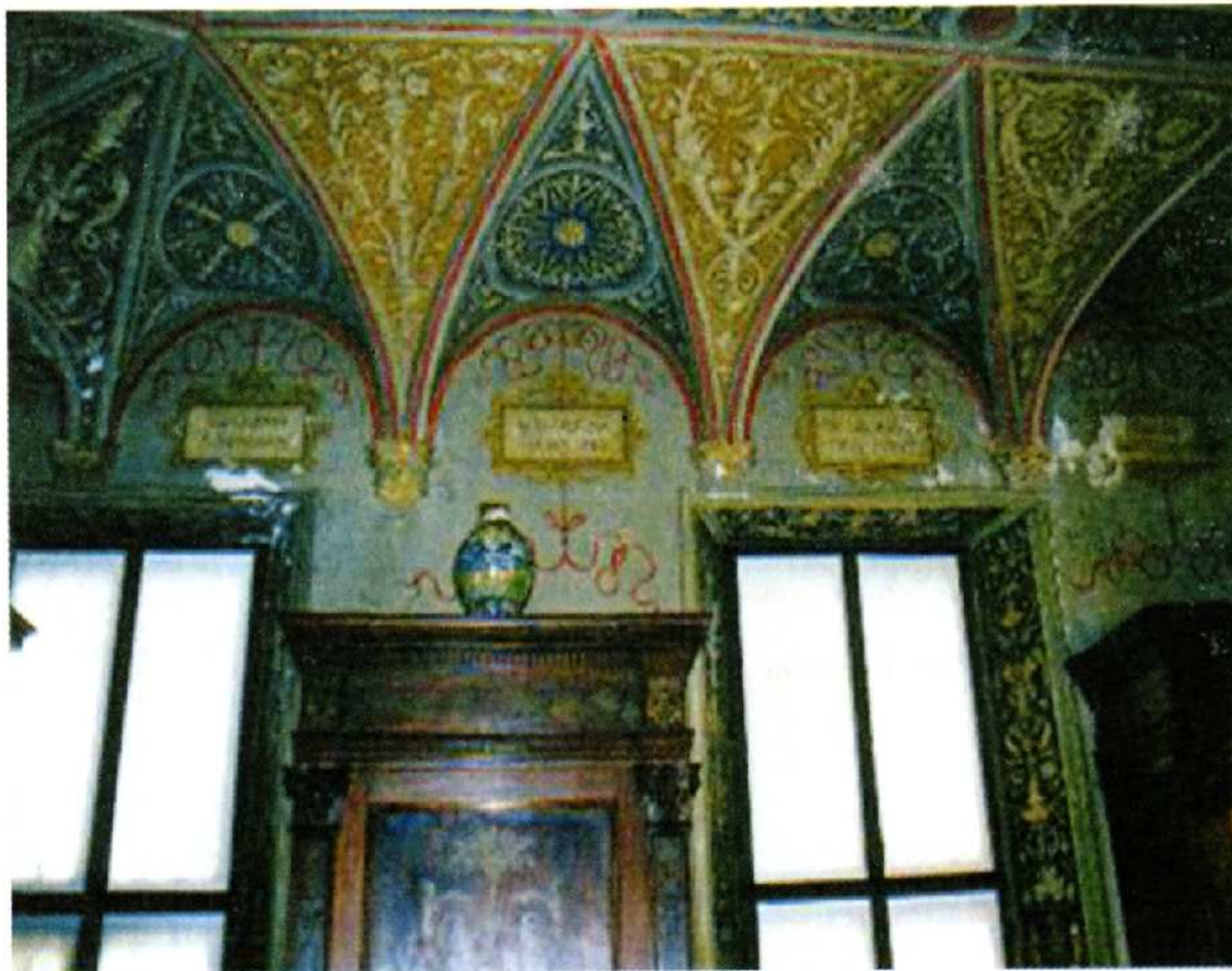
Immagine 16 – Palazzo Bagatti Valsecchi, Milano. Particolare della parete nord della Biblioteca al primo piano in cui si notano evidenti fenomeni di affioramento di sali solubili. Le condizioni microclimatiche di questo ambiente, infatti, risultano condizionate dagli sbalzi termici causati dall'impianto di riscaldamento e favoriscono, pertanto, la formazione di sali.
