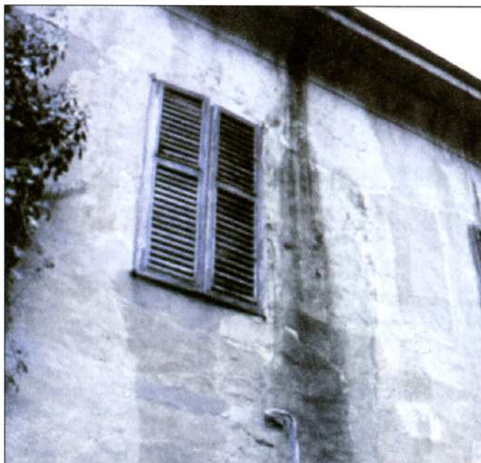
Immagine 8 – Villa Litta-Modignani, Ossona (MI). Particolare del prospetto ovest. Esempio di interazione fra gli elementi. Il cattivo funzionamento dell'impianto di smaltimento delle acque meteoriche, dovuto alla presenza di un foro nel canale di gronda, consente la percolazione dell'acqua piovana lungo la parete causando evidenti fenomeni di degrado sia sull'intonaco esterno sia sulla muratura portante.
