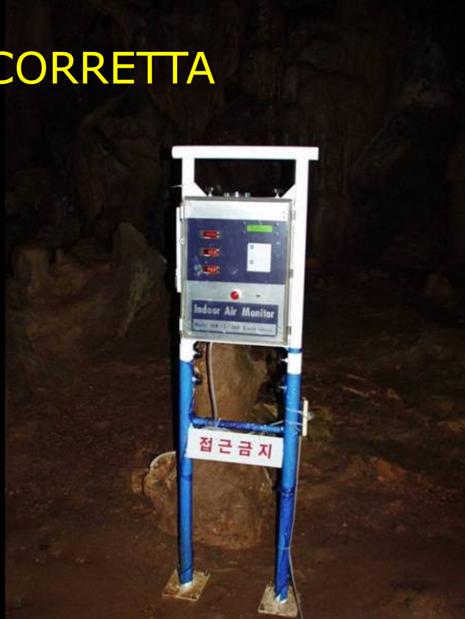
Centralina di monitoraggio in una grotta turistica in Korea (foto P. Forti)
